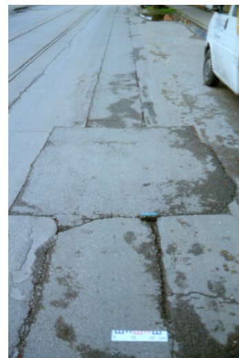
Abbildung 23: Folgeschäden nach unzureichender Instandsetzung nach Grabung [Foto: Streckel]
